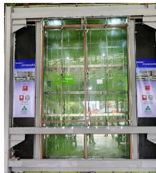
(e) ผลิตภัณฑ์กระจกที่ทำการติดตั้ง
