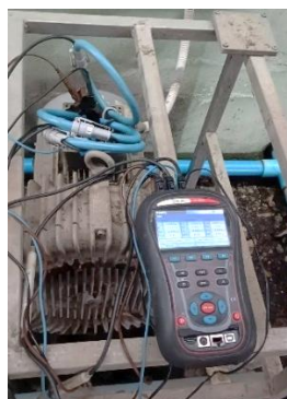
รูปที่ 7 การวัดและบันทึกค่าพลังงานไฟฟ้าด้วยเครื่องมือวัด
