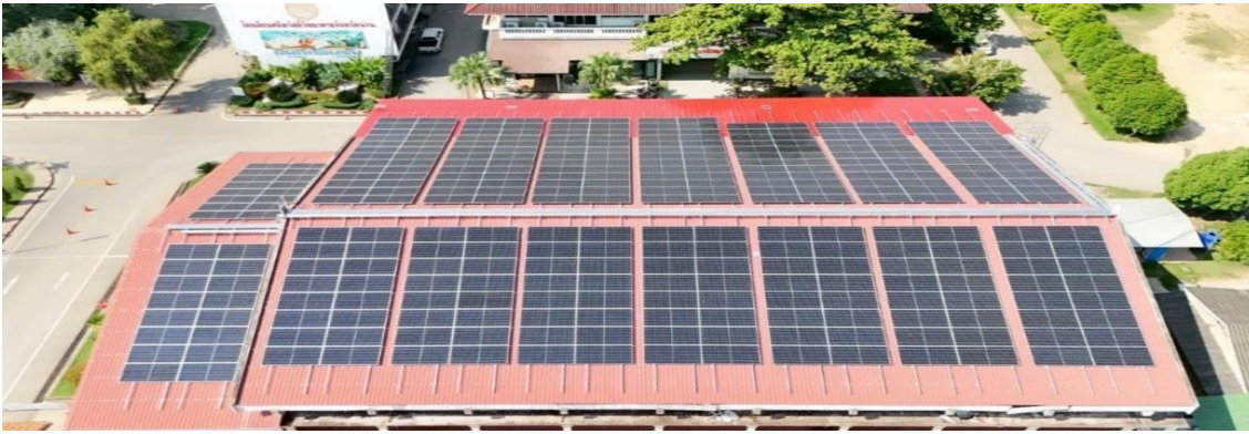
รูปที่ 5 ระบบเซลล์แสงอาทิตย์บนหลังคาขนาด 150 กิโลวัตต์พีค (kWp)
